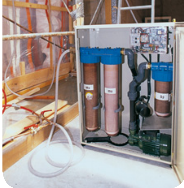
Ensemble de filtration d'eau.
