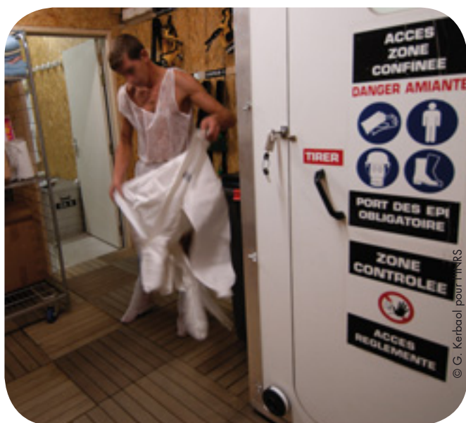
Zone de récupération
