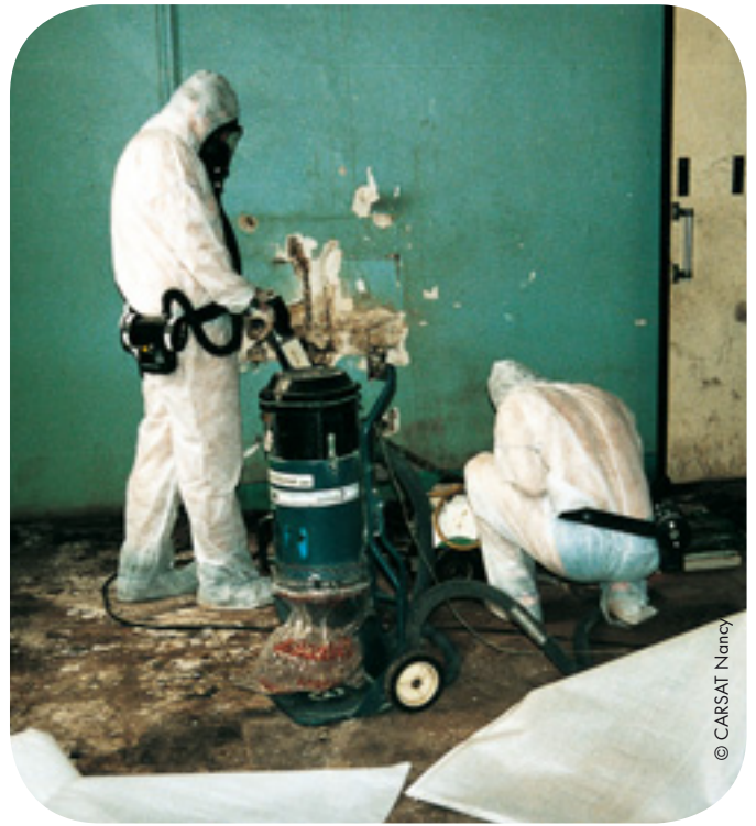
Décollement des dalles sous aspiration.
