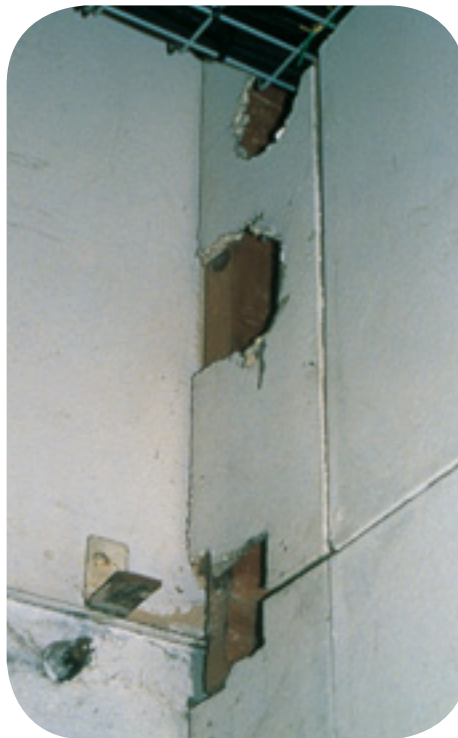
Plaques de carton d'amiante.
