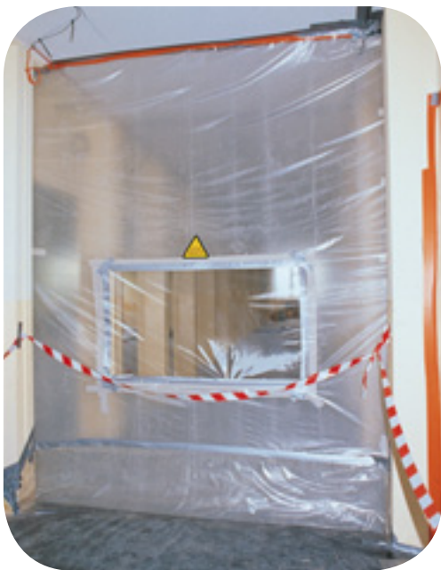
Fenêtre d'observation dans un confinement.
