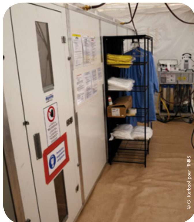
Sas de décontamination à plusieurs compartiments.
